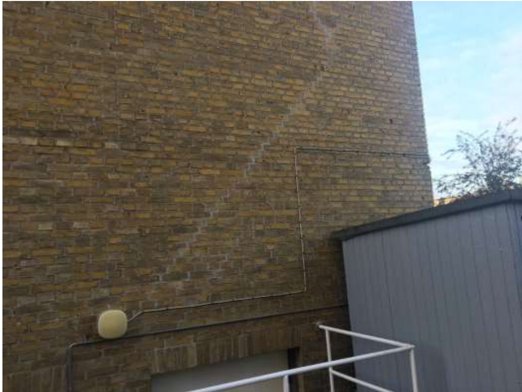
Foto 1. Revne i nordlig gavl, hvor der tidligere er udbedret.
