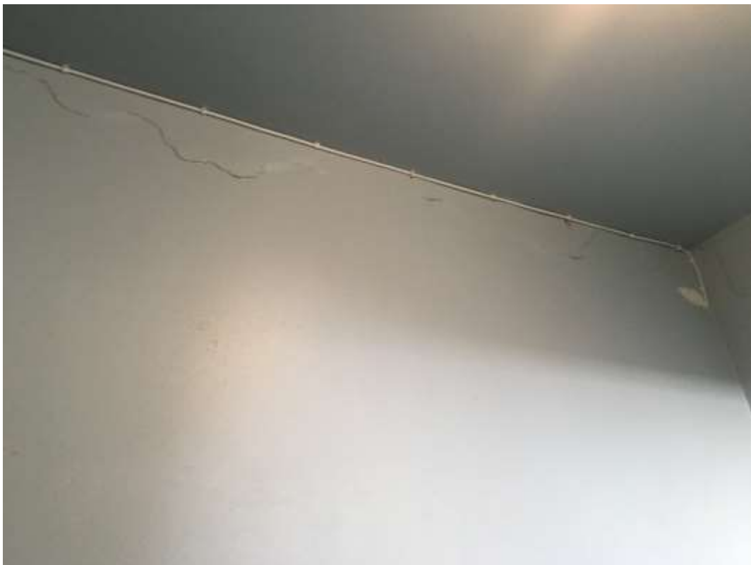
Foto 2. Revne indvendigt i opgang i loft (ved opgang nr. 13).
